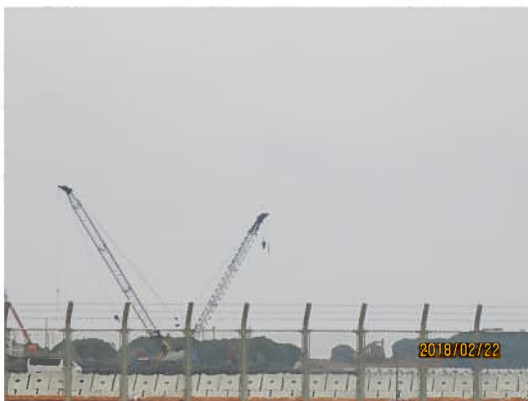
・基地建設が再開されている辺野古沿岸。大型クレーンが海に土砂を投下している。
